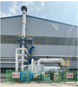
TO 설비(세아제강 군산공장)
